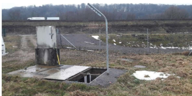
Figure 9 : Photo du poste de refoulement d'Autechaux
